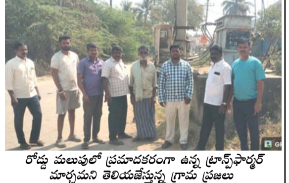
రోడ్డు మలుపులో ప్రమాదకరంగా ఉన్న ట్రాన్స్ ఫార్మర్ మార్చుమని తెలియజేస్తున్న గ్రామ ప్రజలు
